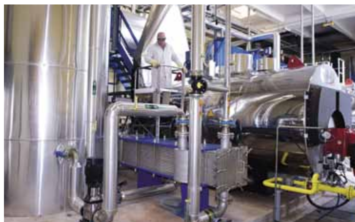
Installation d'éco-efficacité énergétique dans l'usine Vichy.
